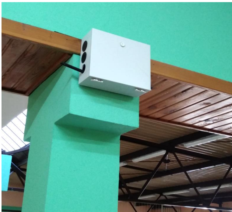
Fot. 4: Zdjęcie punktu dostępowego ukrytego w obudowie
